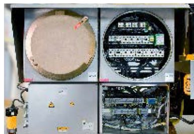
Электрошкафы и управление
